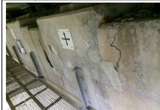
손상현황 • P3 코핑부 들뜸(1.5×1.0) 원 인 • 손상부 우수유입, 철근부식 조치방안 • 단면보수(방청)
